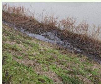
漏水箇所 (調査地点4)
