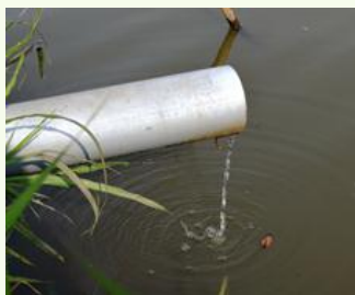
漏水状況 (調査地点1)
