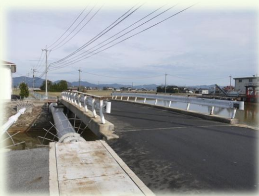
万蔵寺川堤防工事 (佐藤(中家)宅前) 現在は橋が架かり、西(写真左手)に揚水機場、東(写真右手)に中央排水機場が作られている
